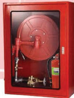
ตู้เก็บสายดับเพลิง HOSE REEL
