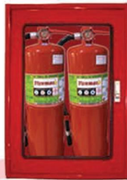
ตู้เก็บถังดับเพลิง 2 เครื่อง
