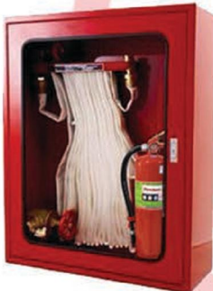
ตู้เก็บสายดับเพลิง HOSE RACK
